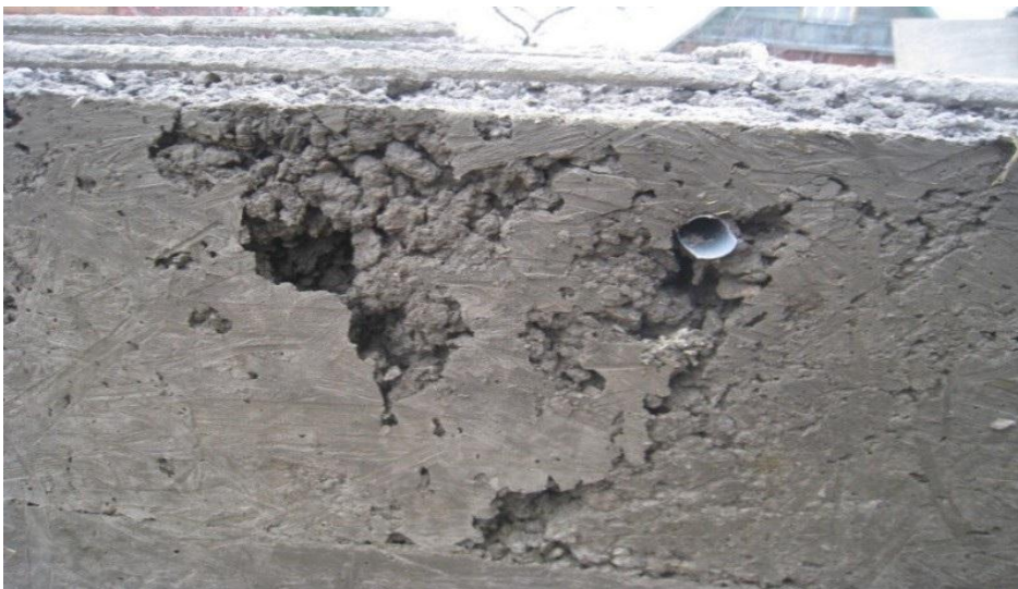
Рис. 3. Пустоты в теле опоры
