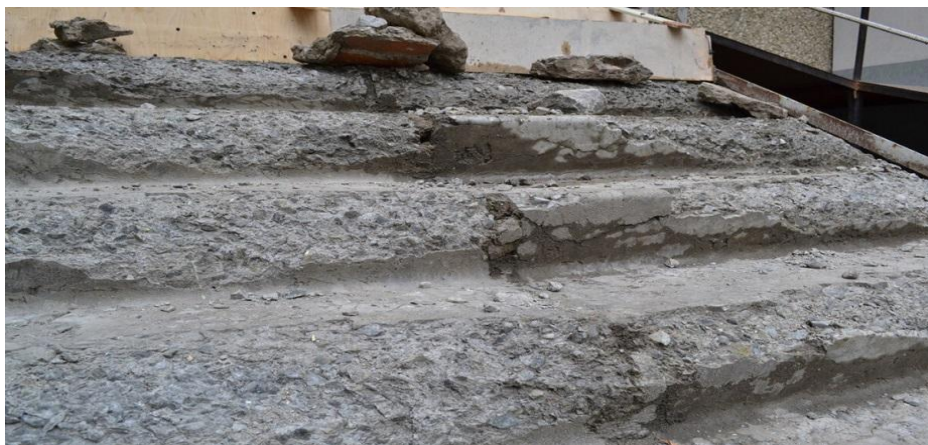
Рис. 4. Морозное разрушение бетона
